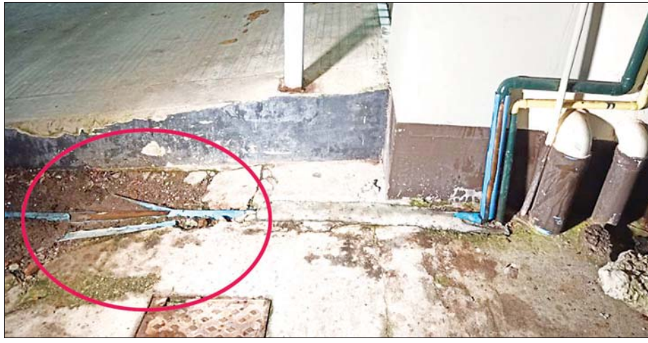
အောက်ဆီဂျင်ပိုက်လိုင်းအား မသမာသူများက ထုတ်ဖျက်ဖျက်ဆီးထားမှုကို တွေ့ရစဉ်။
